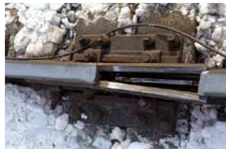
Deň pred Mikulášom došlo na traťovej koľaji medzi železničnými stanicami Podhájska a Hul v km 29 314 k takému lomu koľaje.
