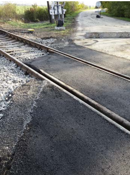
Priecestie po výmene koľajového roštu, úprave GPK a konsolidácii štrkového lôžka v posledný deň výluk vyasfaltovali.
