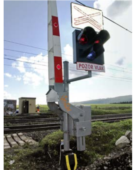
Zariadenia BZKS, umiestnené v novom domčeku, kontrolujú správnu činnosť červených a bielych svetiel výstražníkov a generujú kmitavé impulzy pre dodatočné kódovanie koľajových obvodov na vlakový zabezpečovač.
