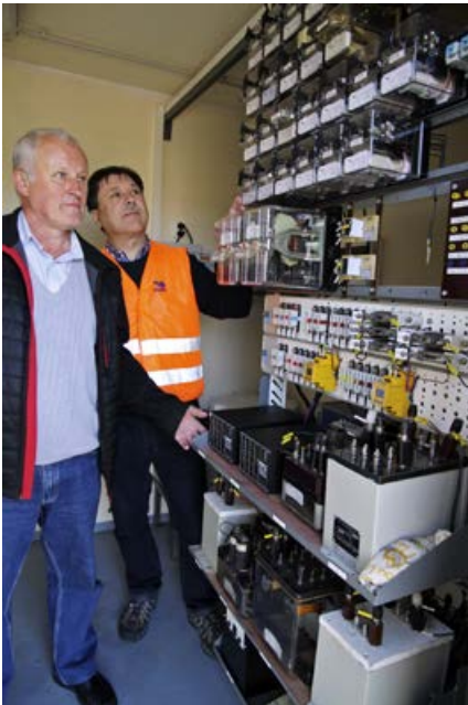
Lubomír Lúčanský a Miroslav Krattinger pri kontrole zrekonštruovaného zariadenia.
