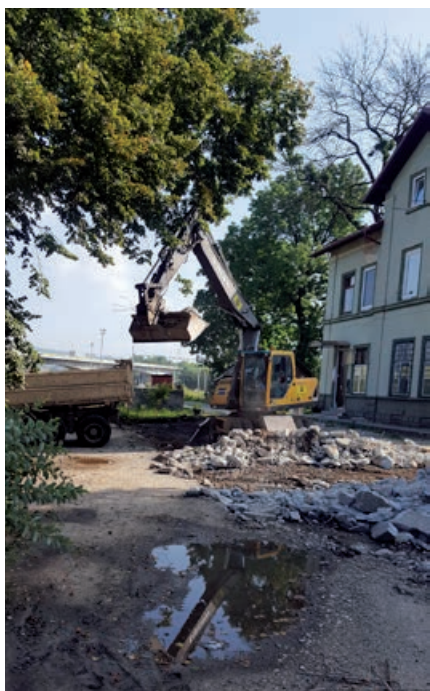
V ŽST Dolný Hričov sa na záver realizuje úprava predstaničnej plochy v rámci splnenia podmienok interoperability (TSI).
