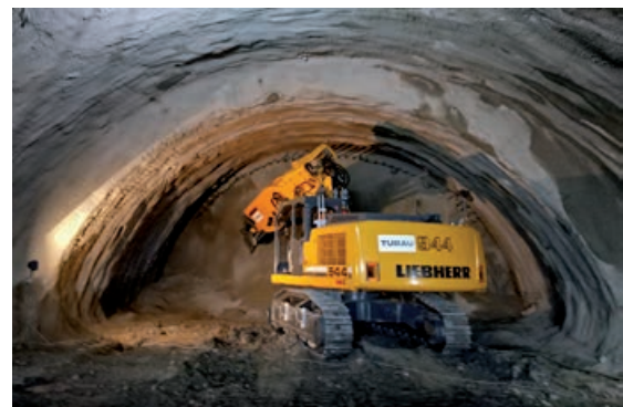
Tunel Diel je razený pomocou skalných bagrov. Zatiaľ je vyrazených 50 metrov z vyše kilometrového tunela.
