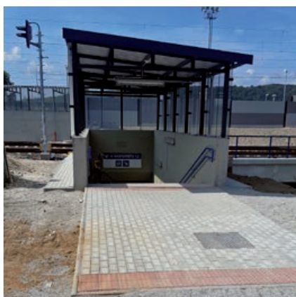
Okolo nového dokončeného podchodu pre cestujúcich v Dolnom Hričove chýbajú k celkovému dokončeniu ešte vonkajšie terénne úpravy.
