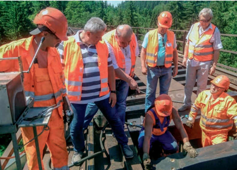
Ján Seman, riaditeľ Mostného obvodu Košice vysvetľuje rozsah a technológiu výmeny mostníc a stykových platní.
