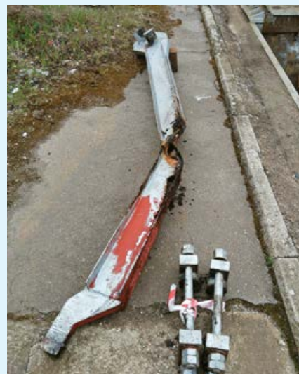
Vybraté skorodované časti mechanizmu váhy.
