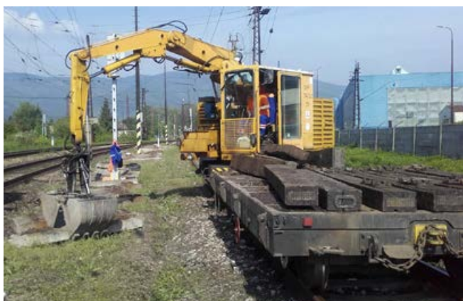
Kus za kus. Ak poškodené drevené podvaly nedržia správny rozchod koľaje, musia sa nahradiť.
