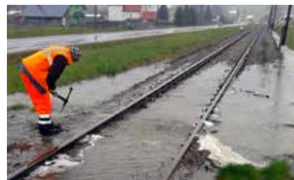
Nedostatočný prietok cestného priepustu na prístupovej ceste k železničnému priestorcu spôsobil zatopenie železničného zvršku v úseku Vysoká nad Kysoucou – Makov.
