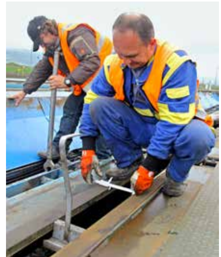
Správny chod masívnych čeľustí koľajových brzd sa pri polročnej revízii meria posuvným meradlom.
