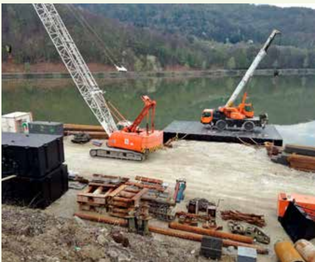
Dovoz a montáž pontónov pre baranenie štetovnic z vody na moste nad nosickou priehradou.
