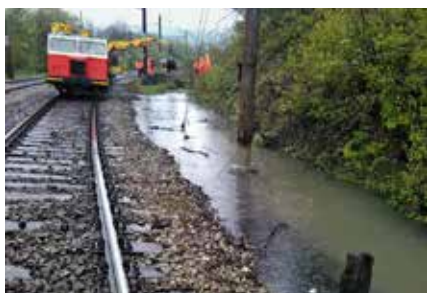
Vysoká hladina vody v železničnej priekope pri 1. traťovej koľaji v úseku Čadca – Krásno nad Kysoucou klesla vybagrovaním odvodňovacej ryhy.
