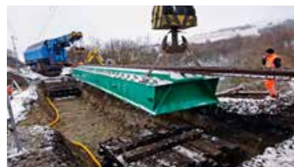
MO Košice v zimnom období zhotovil dočasný most v medzistaničnom úseku Pusté Pole – Plaveč. Na miesto priepustu v havarijnom stave vložil mostné provizorium.
