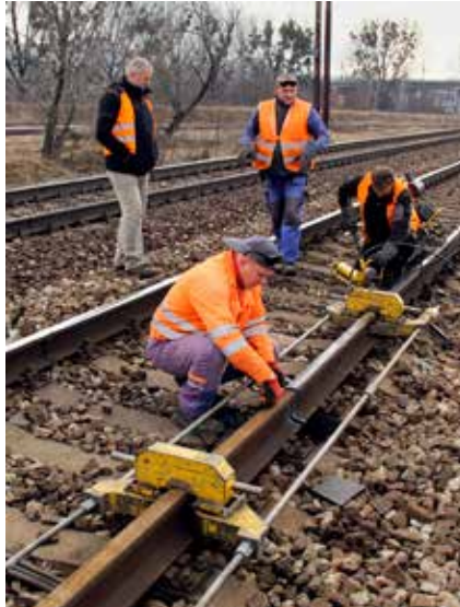
Miloslav Záhumenský (v pozadí vľavo), koordinátor SMSÚ ŽTS TO Margecany, sleduje zamestnancov dodávateľa pri montáži napínacieho zariadenia pred vykonaním záverného zvaru.
