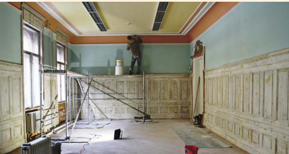
V historickej budove na Železničnej 1 v Košiciach od minulého roku prebieha komplexná rekonštrukcia.
