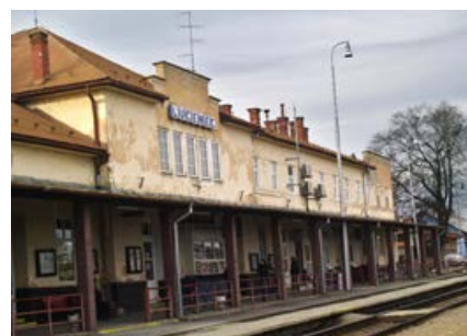
Staničná budova je značne ošarpaná. Rekonštrukcia jej dodá zašlú krásu.
