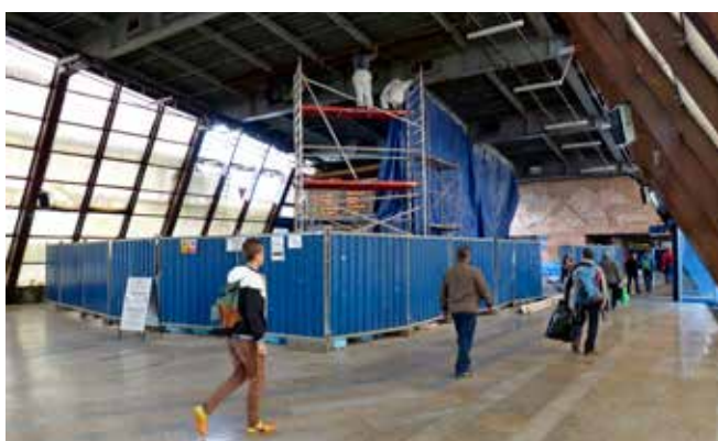
Celá rekonštrukcia na popradskej stanici sa realizuje za plnej prevádzky. Oznamy, vývesky a hlásenia upozorňujú cestujúcich na obmedzenia a zvýšenú pozornosť.
