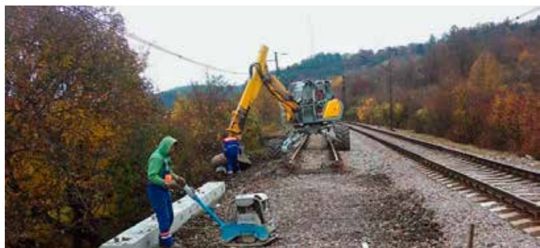
Po ukončení opravy hydroizolácie mostného objektu bolo potrebné uviesť železničný zvršok do pôvodného stavu.
