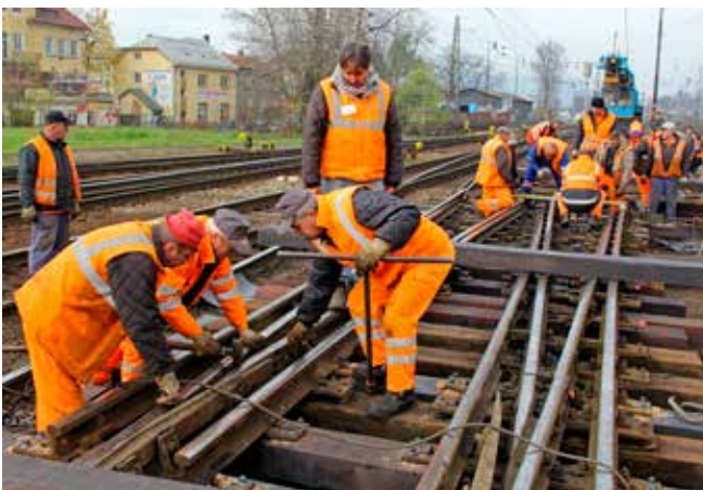
Výluka bola vyhradená na výmenu 31 kusov dosluhujúcich podvalov a opravu poškodených súčastí križovatkovej výhybky.
