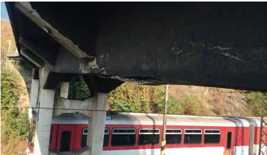
Z mosta na Tupého ulici opadáva betónová krycia vrstva výstuže priamo na prevádzkovanú trať. Bolo potrebné vykonať diagnostiku, ktorej výsledky ukážu, aká budúcnosť most čaka – opraví sa alebo úplne zruší?
