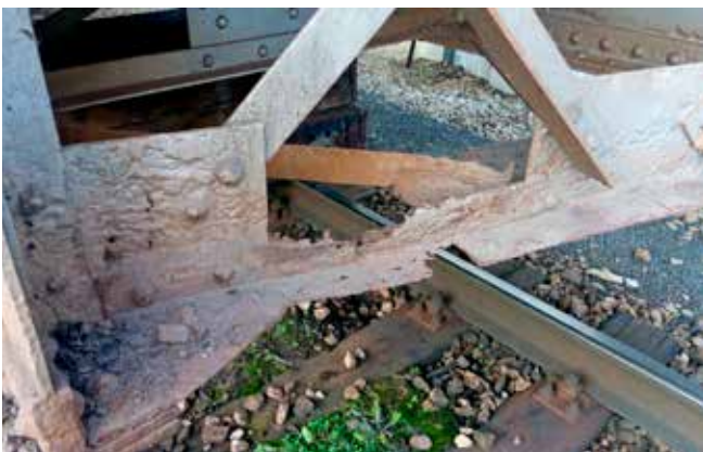
Pohľad na totálne skorodované krajné priečne stuženie mostnej konštrukcie.
