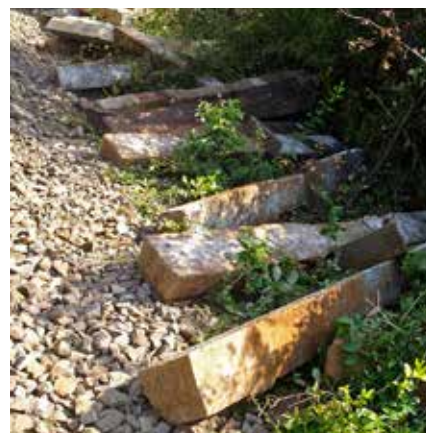
Zničené betónové podvaly zdegradoval služobný vlak, keď sa vykoľajil.
