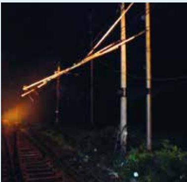
Spadnutý strom potrhál trakčné vedenie.
