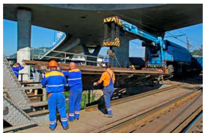
Najťažšou fázou vloženia opravenej oceľovej konštrukcie bolo jej presne uloženie na pôvodné miesta na podperách.
