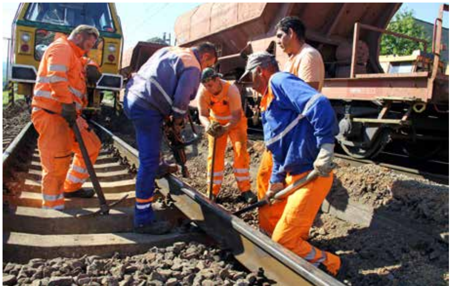
Zamestnanci SMSÚ ŽTS TO Košice popri znížení nivelety 2. staničnej koľaje vymenili aj poškodené podvaly.
