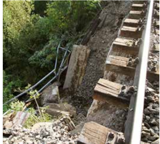
Poškodený most v kilometri 18,025, kde odpadnutie betónového parapetu z ľavej strany spôsobilo zosun časti štrkového lôžka z priestoru pod podvalom. Parapet so zábradlím, aj časť lôžka sa zosunuli do potoka.
