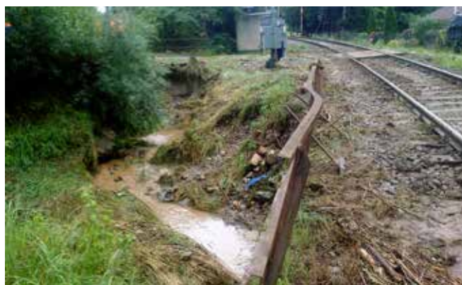
Zaplavený priepust po silnom daždi spôsobil problémy v Gašparove.
