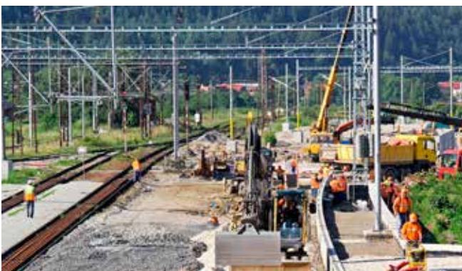
Obnova párnej skupiny koľají a výhybiek na bratislavskom zhlaví stanice. V tomto mieste začína preložka trate. Budované nástupište sa preto odchyľuje od pôvodnej trasy železničného telesa.
