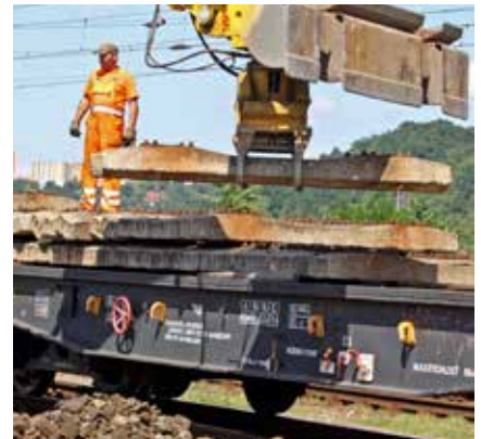
Stroj Atlas je pri pokladaní nových, ale aj pri odstraňovaní starých podvalov neoceniteľným pomocníkom.
