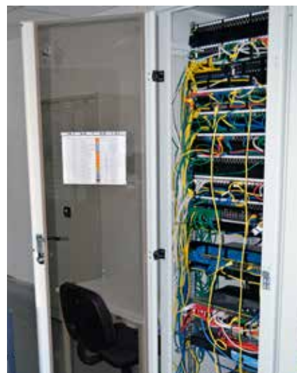
Telefónne prepojenia z privátnej železničnej siete do verejných hlasových sietí iných operátorov realizujú Železničné telekomunikácie prostredníctvom modernej ústredne SBC.
