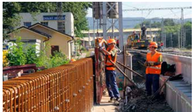
Montáž debnenia oporného múrika 2. nástupišťa. V stanici budú dve nástupišťa, dlhé 250 metrov, na ktorých sa budú nachádzať štyri prístrešky. Ochrana cestujúcich pred prípadným pádom pri nástupišti č. 2 je riešená osadením kovového zábradlia. Ochrana pri nástupišti č. 1 je riešená protihlukovou stenou.
