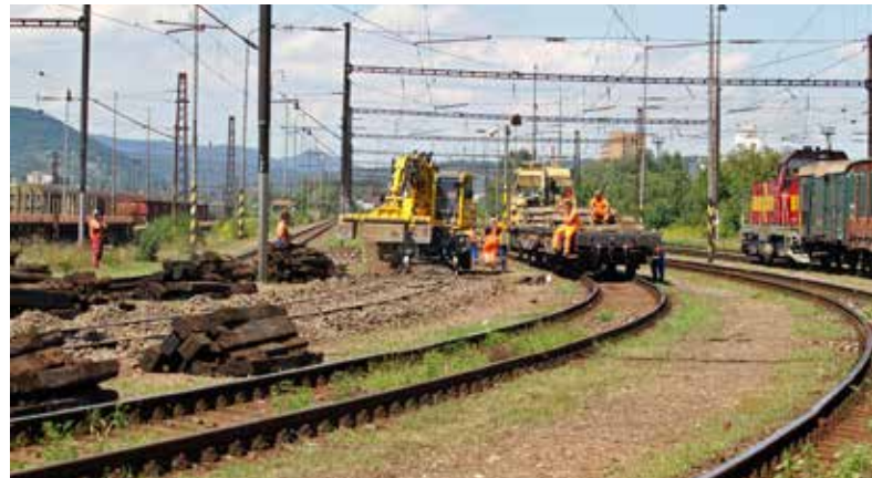
Na koľaji č. 158 na košickej nákladnej stanici vymenili začiatkom augusta 685 drevených podvalov za betónové.
