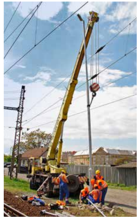
Sklápacie stožiare s LED svietidlami prinesú ŽSR úsporu elektrickej energie aj výlukových hodín.
