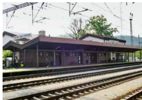
Výpravnú budovu poškodzujú problematické dažďové žľaby.
