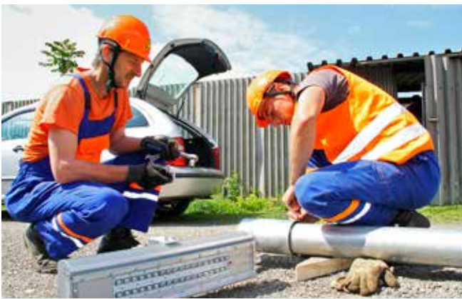
Elektromontéri Ján Straka a Aleš Čakl montujú úsporné LED svietidlo na sklápací stožiar.
