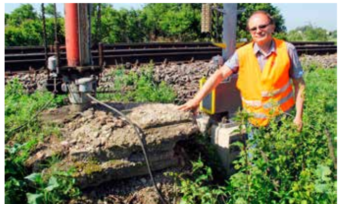
S Michalom Ihnátom sme sa pristavili aj pri oslabenej päte stožiaru mechanického návěstidla. Takto rozrušený betónový základ odolával otrasom, ktoré sa diali pri každom prestavení mechanického návěstidla.
