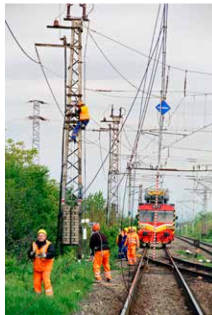
Rušenie križovania nepotrebného trolejového vedenia s trolejom nad oboma hlavnými traťovými koľajami sa udialo v 50-minútovej vlakovej prestávke.
