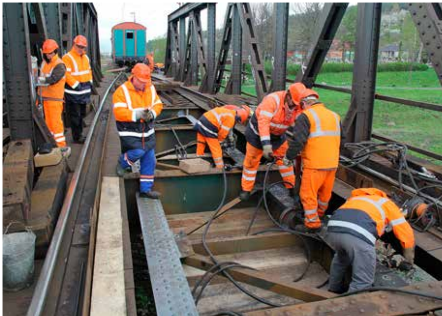
Ocelový priehradový most pri sídlisku Podbreziny v Liptovskom Mikuláši si už žiadal výmenu mostníc aj pásnic, ako aj opravu trhlín stien pozdĺžnikov a krčných uholníkov.
