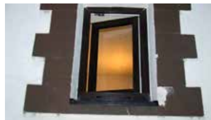
Cez toto okno sa zlodej alebo zlodeji dostali do priestorov budovy, v ktorej je šatňa traťovákom v Novej Bani.
