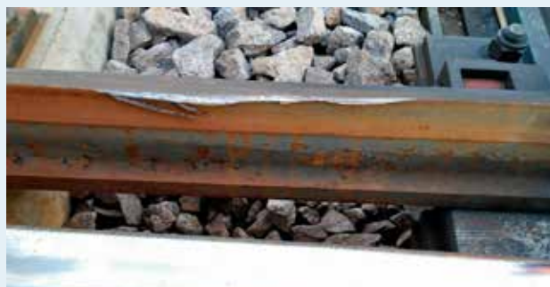
Detail poškodeného jazyka po rezaní štíhlej výhybky.
