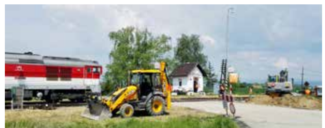
Jednodrôtové mechanické závery v Bošanoch nahradilo praecestné zabezpečovacie zariadenie 3. kategórie so svetelnou signalizáciou bez závor.
