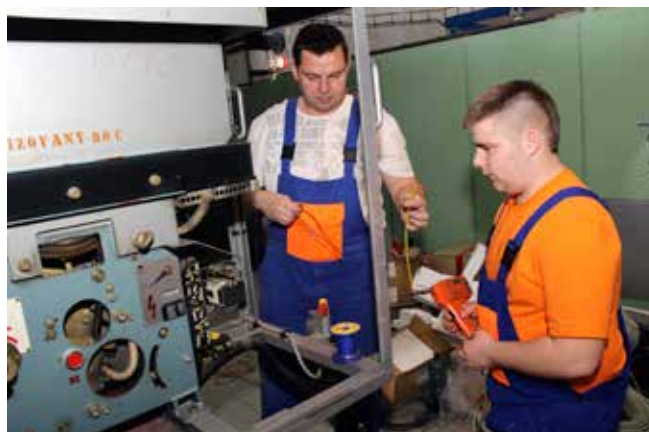
Elektromontéri Jozef Petro a Marian Beňo upravujú elektrické obvody rýchlo vypínača, aby meniareň ostala v prevádzke aj počas rekonštrukcie.
