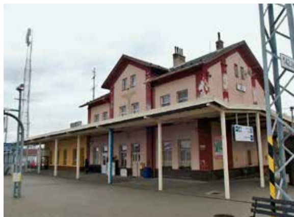
V Ilave sa štandardy začali uplatňovať až s nástupom tohto roka. Pri pohľade na staničnú budovu je zrejmé, že správcu čaká ešte veľa náročnej práce.
