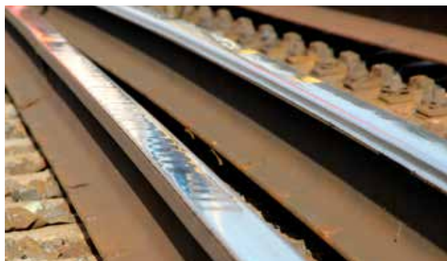
Vlnkovitosť zaznamenaná na ľavom koľajnicovom páse, ten napravo má už vplyvom pôsobenia síl od koľajových vozidiel ojazdenú hlavu.
