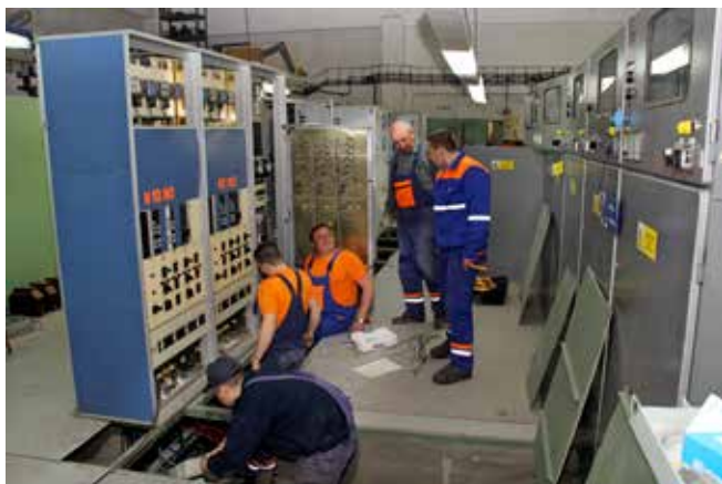
Zamestnanci SMSÚ EE NaSpS Košice demontujú manipulačný rozvádzač pôvodného riadiaceho systému MRSY 1.
