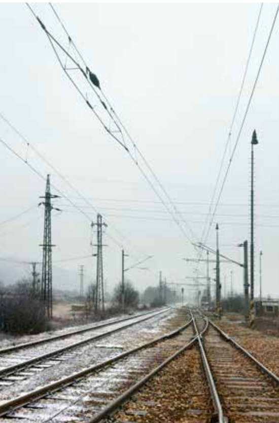
Úsekový delič pre trakčné vedenie 25 kV, 50 Hz na zvolenskom zhlaví ŽST Žarnovica nad koľajovou spojku medzi 1. a 2. koľajou.
