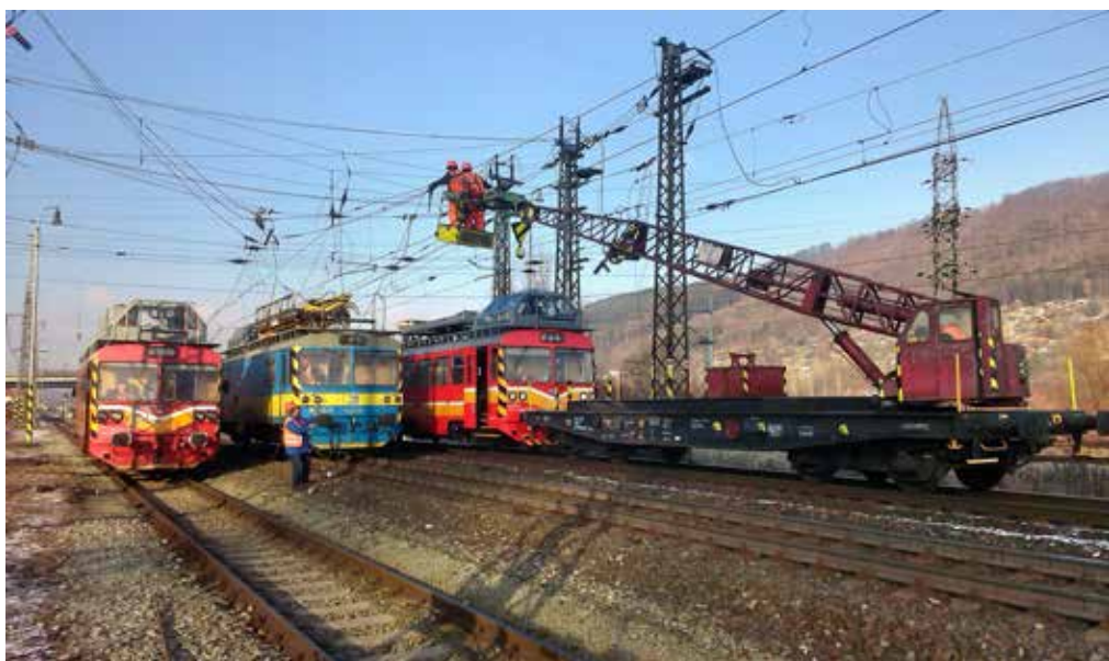
Následky poškodenia trakčného vedenia odstraňovali zamestnanci SMSÚ EE TV Žilina.
