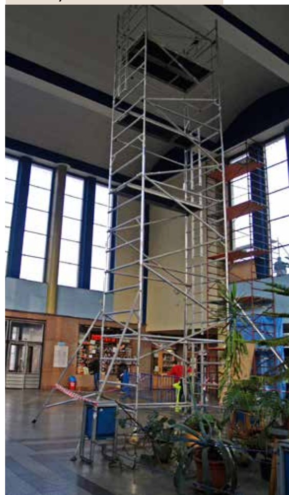
Sklenené výplne vo veľkom vestibule vo zvolenskej železničnej stanici boli pôvodné a bolo nutné ich vymeniť.
