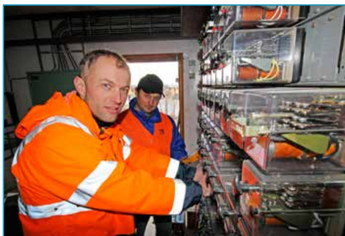
František Bačík a Milan Bohuš z SMSÚ OZT ZT Trenčianska Teplá deaktivujú v reléovom domčeku priecestné zabezpečovacie zariadenie.
