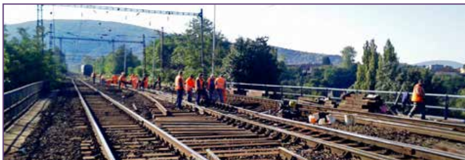
Počas celého týždňa na opravách pracovali aj zamestnanci SMSÚ ŽTS TO BA z Devínskej Novej Vsi a Malaciek.
