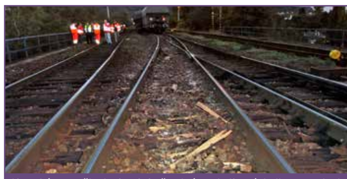
Aj takéto poškodenia infaštruktúry boli následkom nehody v Devínskej Novej Vsi.
