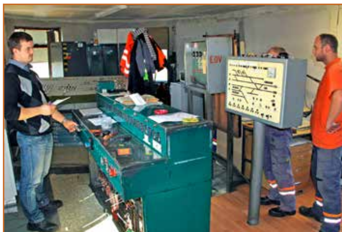
Elektrodynamickému stavadlovému prístroju na stavadle 2 sa nevyhli úpravy. Do indikačnej dosky boli doplnené nové kontrolné prvky.
