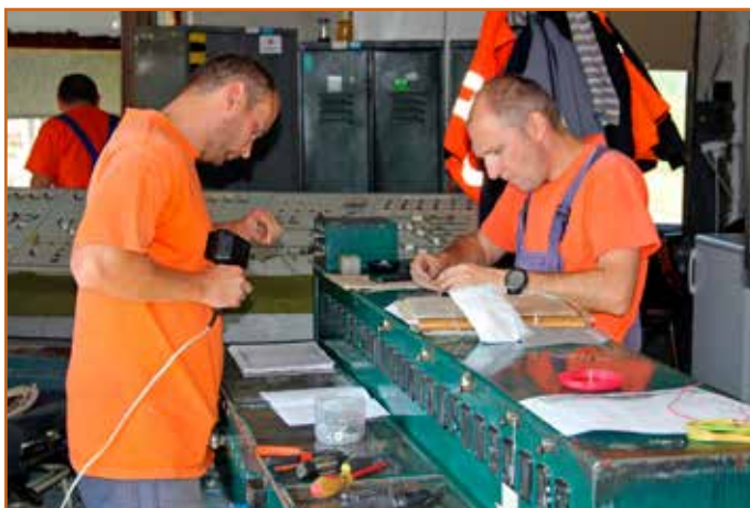
Návestní majstri Peter Pochyba a Rudolf Stolárik z SMSÚ OZT ŽTS Vrútky naspájali množstvo vodivých prepojení od reléových závislostí ovládania prestavníkov so zostávajúcou časťou elektrodynamiky.
