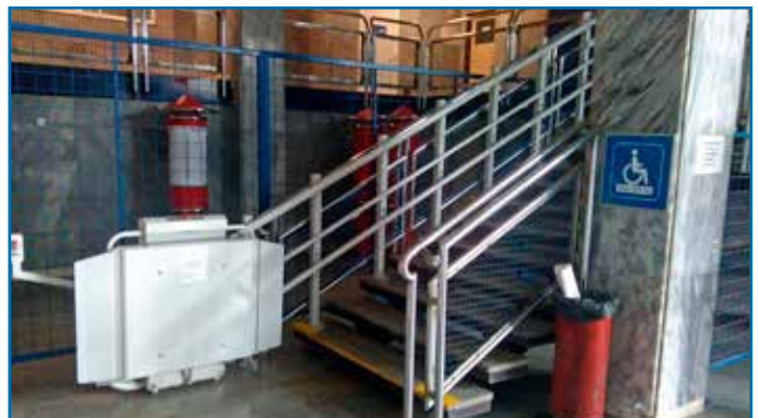
V Prešove boli osadené 2 schodiskové zdvižné plošiny pre osoby s obmedzenou mobilitou.
