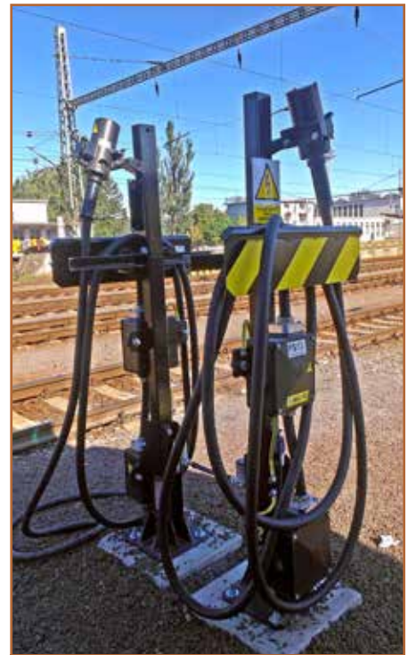
V obvode osobnej stanice vo Zvolene je rozmiestnených 17 predkurovacích stojanov.
