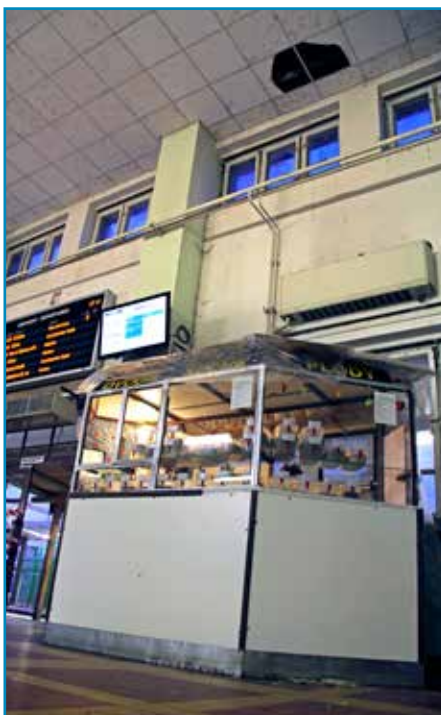
Vo februári 2015 dopadla vo vestibule premočená časť stropu priamo na predajný stánek. OR Žilina ešte do začiatku zimy vyčistí podhľad vestibulu a vymaľuje jeho steny, ako aj steny čakárne.
