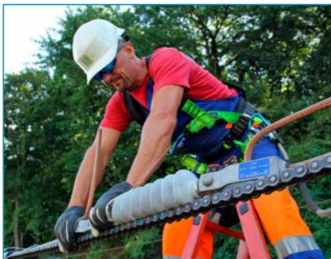
Nad fázovým deličom bolo potrebné umiestniť izolátor, aby bola izolovaná spojka v trakčnom vedení medzi dvoma napájacími sústavami úplná.
