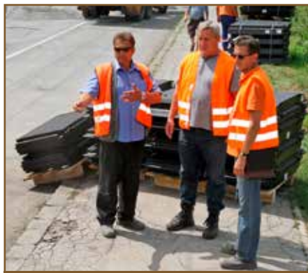
Dobrá koordinácia a správne postupy prác sú dôležité počas celej vyluky. Vedia o tom svoje aj Jaroslav Bednarčík, šéf prešovských traťovákov (v strede) Jozef Jančuš, správca ŽI (vľavo) a Ján Maťufka, koordinátor (vpravo), ktorí na stavbe dohliadali.
