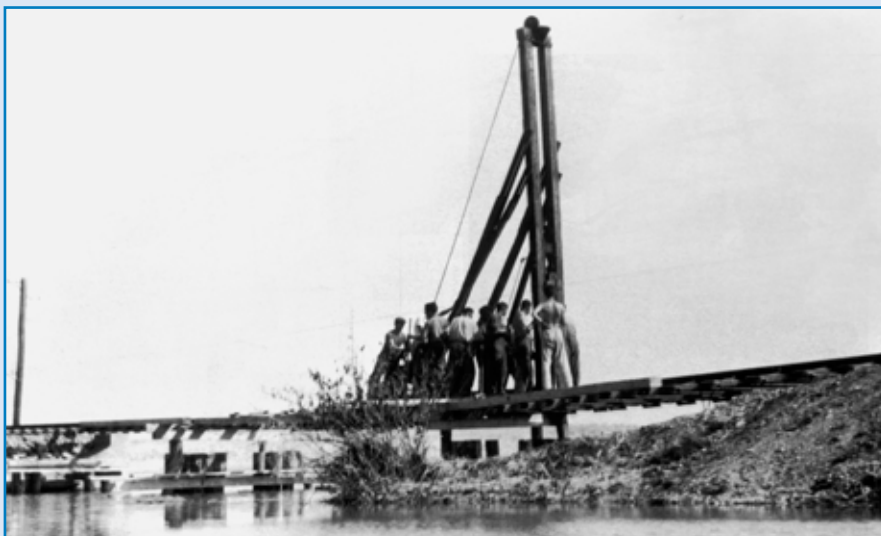
Odplavené násypy sa museli dočasne premostovať. Mostári používali techniku baranenia pilotových drevených bárk, na ktoré montovali mostné provizoriá.
