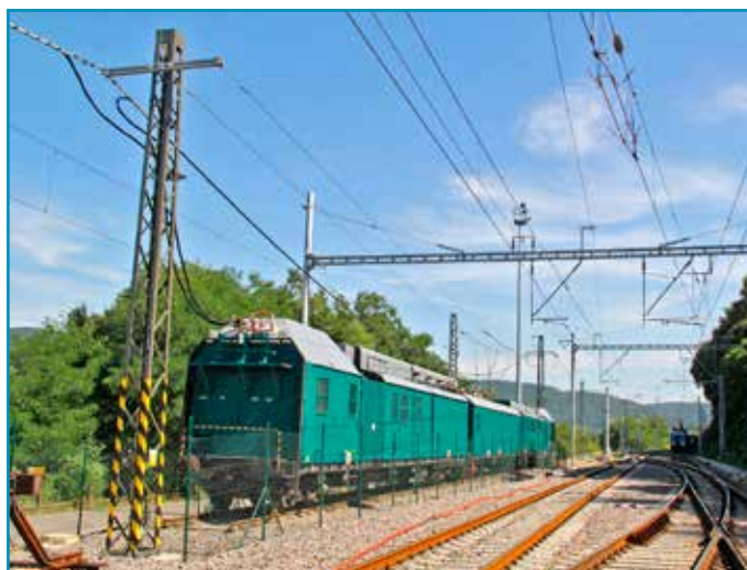
Za žilinským zhlavím ŽST Púchov je styk medzi striedavou trakciou stanice a jednosmernou trakciou na trati. Prevozná trakčná meniaren bude dočasne napájať úsek smerom k Považskej Bystrici jednosmerným napätím.
