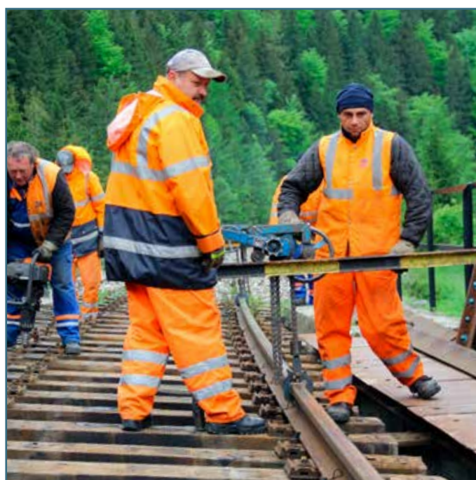
S koľajnicami na moste nad vodnou nádržou manipulovali zamestnanci SMSÚ ŽTS TO Margecany. V 500-metrovom úseku za mostom zároveň znížili niveletu koľaje a vykonali aj jej smerovú a výškovú úpravu.
