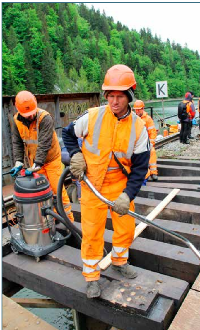
Načo je vysávač na moste? Mostnice a piliny z nich sú morené ekologickou impregnačnou látkou. Mostári ich vysávajú, aby sa nedostali do vodného toku pod mostom. Aj keď je to bežná prax, ochranári apelovali pred opravami na elimináciu znečistenia vodnej nádrže.
