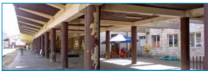
Opadaná farba krytého nástupištia pri výpravnej budove takisto nespĺňa podmienky štandardov.
