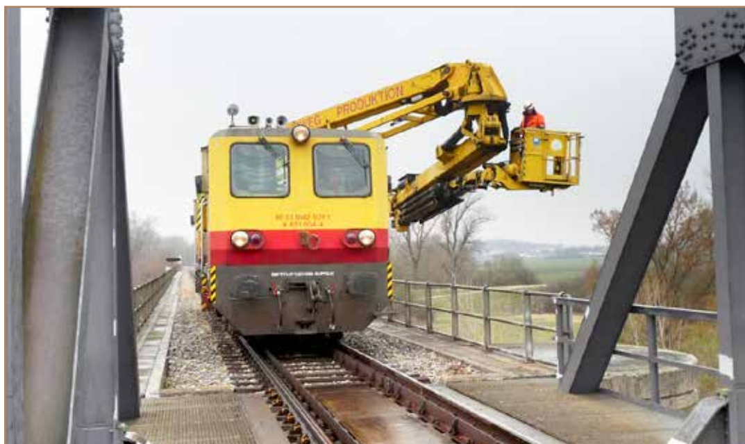
Revízia mosta trvala dva dni, pri ktorej bolo využité rakúske diagnostické zariadenie BCR-100. Vyrobené boli len 3 takéto zariadenia a v dnešnej dobe sú funkčné už len dva.
