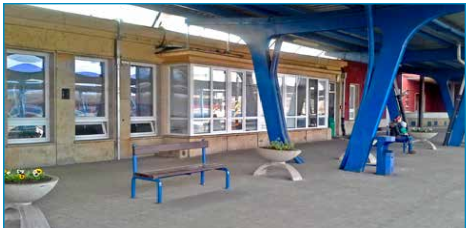
Staré lavičky sú už poškodené a predpísané sektorové sedenie ešte chýba.
