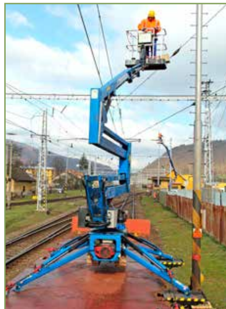
Pracovná plošina uchytená na plošinovom vozni zefektívni údržbu ťažšie prístupných osvetľovacích stožiarov v kolajisku.
