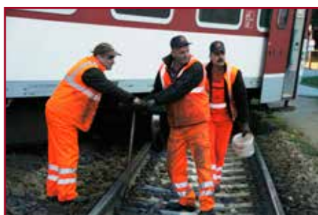
Rozsah poškodenia koľajového zvršku nebol veľký. Traťováci najskôr ručne podoťahovali uvoľnené matice a po nakoľajení vozňa podbijačka opravila smerové vybočenie koľají.
