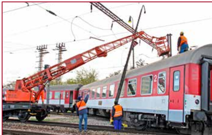
Vozeň vážne poškodil aj osvetľovací stožiar. Elektrikári ho museli odstrániť.
