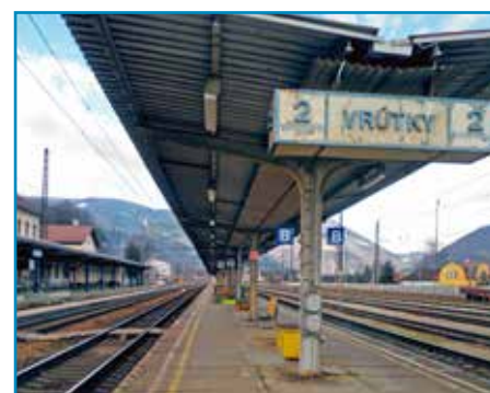
Najväčšiu opravu si žiada ostrovné druhé nástupište, ktoré nevyhovuje požiadavke bezbariérového prístupu pre imobilných cestujúcich.
