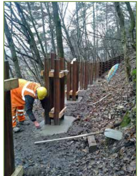
Osadené a zabetónované koľajnice v páse, ktorý sa tiahol pozdĺž kopca, aby po dokončení zabránil padaniu skál.
