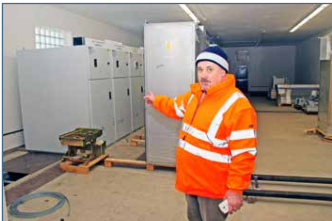
Technológia napájacej stanice sa postupne dováža a zapája. Ondrej Paluch ukazuje v technologickej miestnosti na časť rozvádzačov a vypínačov, ktoré sú už zmontované na mieste.
