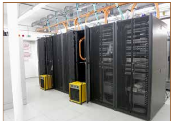
Aj takto vyzerá časť datacentra na Kováčskej.
