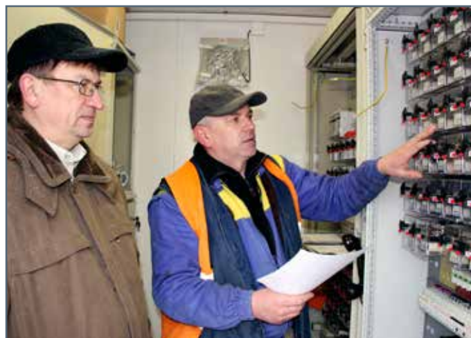
Naľavo Emil Forgáč zo sekcie OZT OR Zvolen a elektromechanik Stanislav Hodina z AZD Bratislava kontrolujú v reléovom domčeku v Tekovskej Breznici výstroj novovybudovaného automatického hradla a zabezpečovacieho zariadenia miestneho priecestia.
