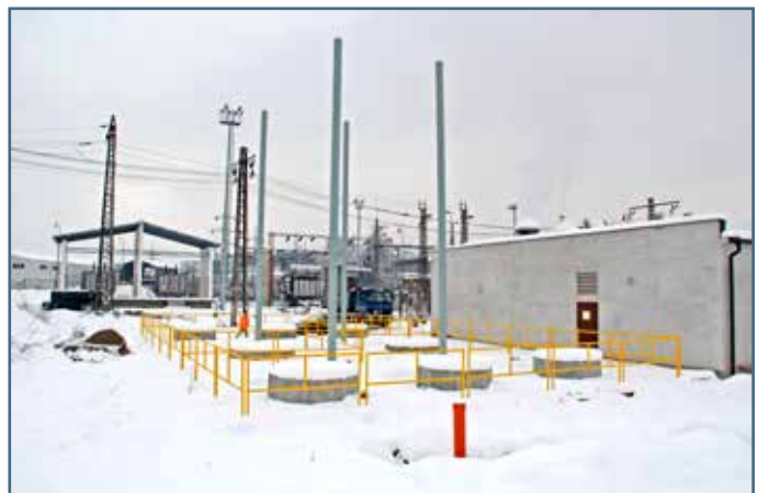
Okrem novej rozvodne 110 kV napätia a budovy s technológiou sú pod snehom aj stanovišťa pre prvky kompenzačného zariadenia. Spustenie napájacej stanice do prevádzky je plánované na september.
