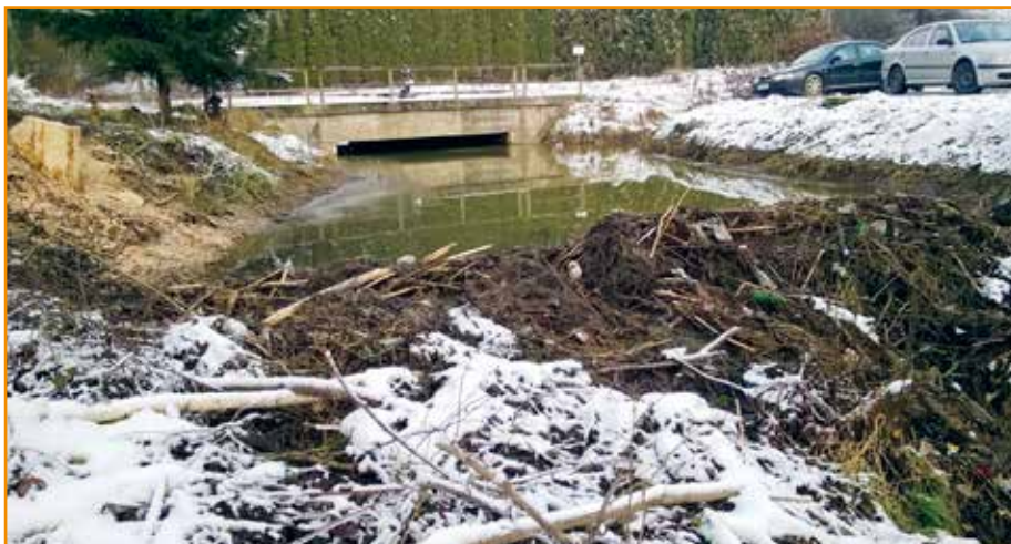
Dielo bobra vodného. Stav trate je pravidelne kontrolovaný a zatiaľ nie je ohrozená bezpečnosť železničnej prevádzky.
