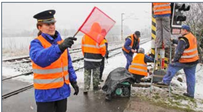
Výpravkyňa Ludmila Ondrejková (naľavo), ktorá 17 rokov slúžila v Tekovskej Breznici, tentoraz v pozícii závorárky stráži miestne priecestie, pretože zabezpečovacie zariadenie je vypnuté. V pozadí zamestnanci zhotoviteľa osadzujú nový výstražník.
