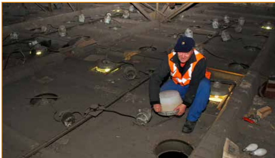
Odvrátená strana vstupnej haly – jej povalu. Bohumír Varga otvára jednu zo zhasnutých lúč, aby zistil príčinu poruchy. Robí to opatrne, aby mu starobou krehký plastový kryt nepraskol, prípadne sa neskôr nerozpadol nad hlavami cestujúcich. Z tohto dôvodu si už osvetlenie žiada modernizáciu.
