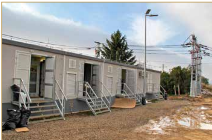
Kontajnerová meniareň privádza napätie k stožiaru vývodov s úsekovými odpojovačmi, odkiaľ je napájané trolejové vedenie na trati. Areál meniarne osvetľujú moderné LED svetidlá.
