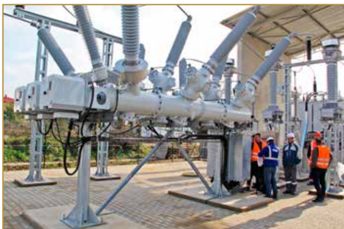
V novej 110 kV rozvodni dominuje moderný modulárny rozvádzač. Sústreďuje komponenty, ktoré boli v starej rozvodni rozmiestnené samostatne. Ukryva meracie transformátory prúdu, výkonové vypínače, odpojovače aj skratovače.
