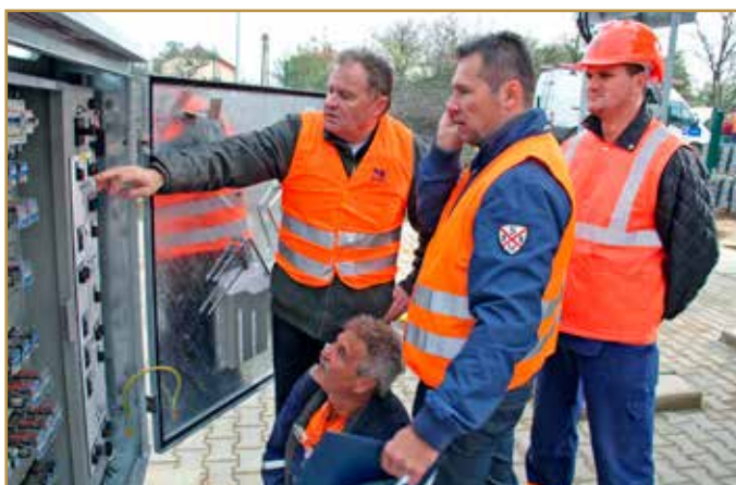
Zľava Ing. Milan Skokan, vedúci SMSÚ EE NaSpS Košice, čipiaci majster Ladislav Hajdu, Ing. Ján Sedláček odvetvový správca sekcie EE Košice a elektromontér Pavol Bodnár skúšajú v 110 kV rozvodni ovládanie jednotlivých komponentov a blokovanie nedovolených operácií.
