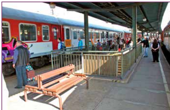
V stanici je pôvodné už len druhé nástupište. Jeho rekonštrukcia je naplánovaná od 10. novembra. Osobná vlaková doprava počas stavebných prác bude vedená obdobne, ako bola vedená počas rekonštrukcie nástupištia č. 1, budú sa teda využívať nástupištia č. 1, 3 a 4. V investičnom pláne je zaradené aj prepojenie vchodu do podchodu od pošty z Dohnányho ulice s chodbou smerujúcou k výtahom.
