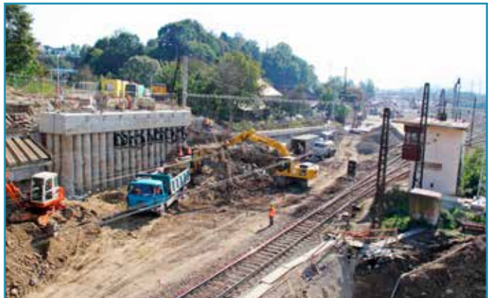
Na žilinskom zhlaví pod koľajami č. 1 a 3 boli objavené archeologické nálezy v susedstve Záskaľského potoka a oblasti výstavby. Nevyhnutnosť archeologického prieskumu oddialila termíny výlukových prác až do roku 2015.
