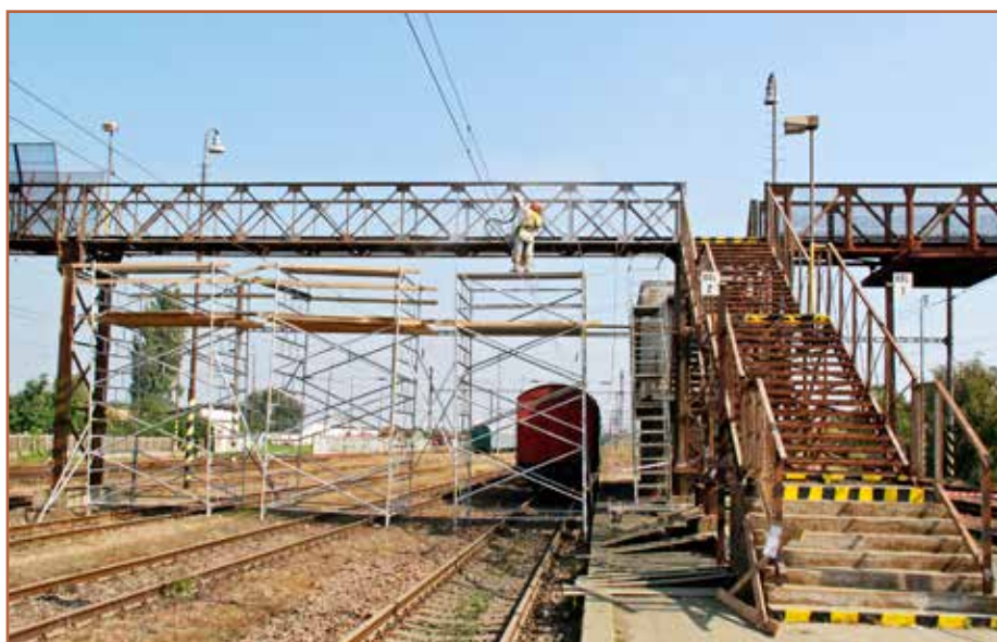
Lávka vo Vajnoroch je frekventovaným priechodom pre miestnych obyvateľov. Až po obnažení nosnej konštrukcie sa ukázal jej zlý technický stav.
