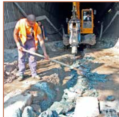
Kolajový rošt z betónu sa musel rozbiť, potrebná je úprava odvodnenia tunela.
