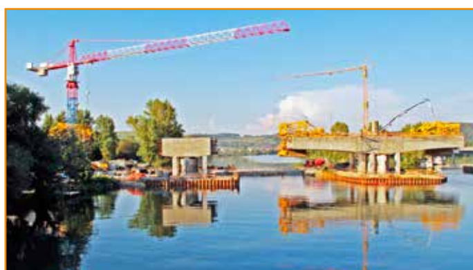
Nad Váhom sú čoraz zreteľnejšie obrysy 7 polového železničného mosta s dĺžkou 343 m. Pracuje sa na jeho nosnej koštruktívii z predpätého betónu, realizovanej metódou letmej betonáže. Železničný zvršok bude tvoriť pevná jazdná dráha. Ukončenie prác je naplánované na leto 2015.
