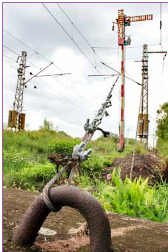
Nestabilné vchodové návestidlo vo Veľkom Horeši je kvôli bezpečnosti vyviazané tromi lanami.
