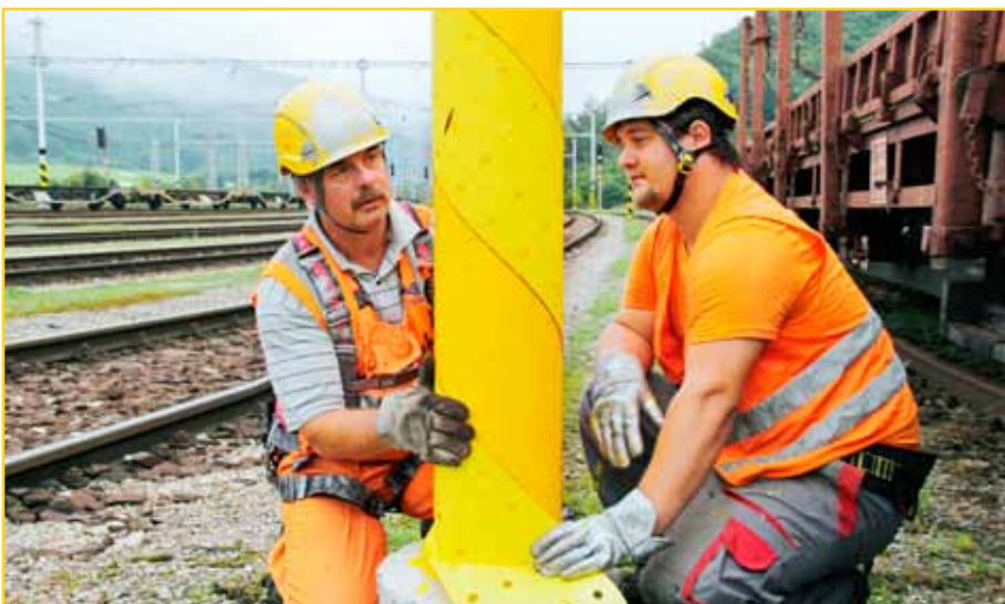
Zlva Ján Holotňák a Michal Vašák, elektromontéri pevných trakčných a silnoprúdových zariadení podpier majú na natieranie bezpečnostného náteru pomôcku. Najskôr ju na žltý podklad obkreslia...
