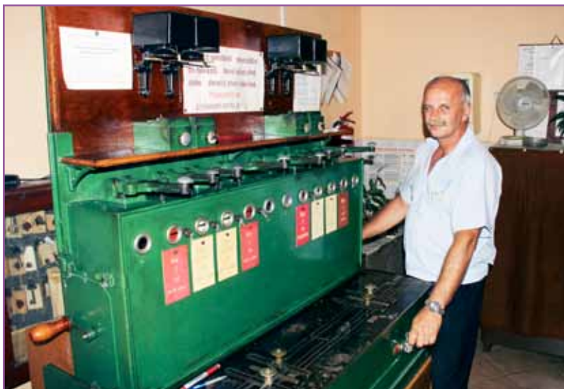
Výpravca Štefan Doša dáva v riadiaceho prístroja pokyn na stavadlo k obsluhu mechanického návestidla. V stanici by privítal nové zabezpečovacie zariadenie.
