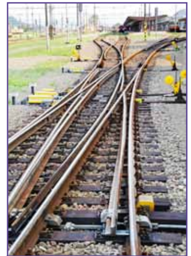
Raritná križovatková výhybka s pohyblivými hrotmi srdcovky, na ktorej sú namontované až 4 čelustové závery.
