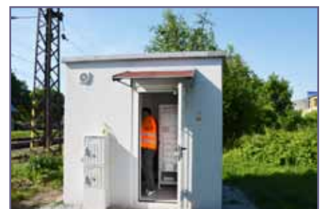
Technológia chorvátskeho PZZ bola umiestnená v novom betónovom domčeku.
