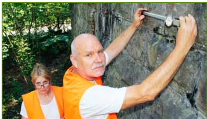
Marián Anguš, vedúci prevádzkovej skupiny a Milada Palkovičová, vedúca oddelenia merania a skúšok dráhových mobilných prostriedkov z VVÚŽ pri meraní zvislých trhlín na Čertovom viadukte.
