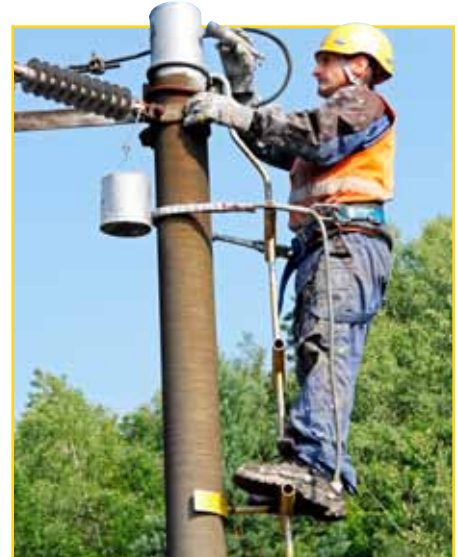
Elektromontér Ladislav Ivančák z SMSÚ EE TV Košice rutinne natiera stožiar vo výške 12 metrov.
