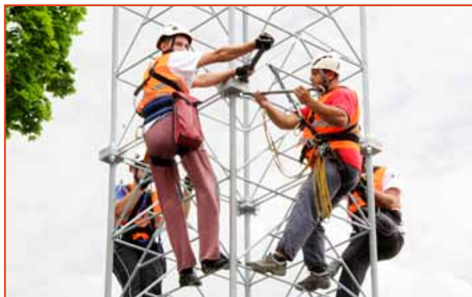
Zmontované stožiare ponesú antény GSM-R s úzkym horizontálnym uhlom cca 35° tak, aby pokryli železničnú trať a jej bezprostredné okolie.
