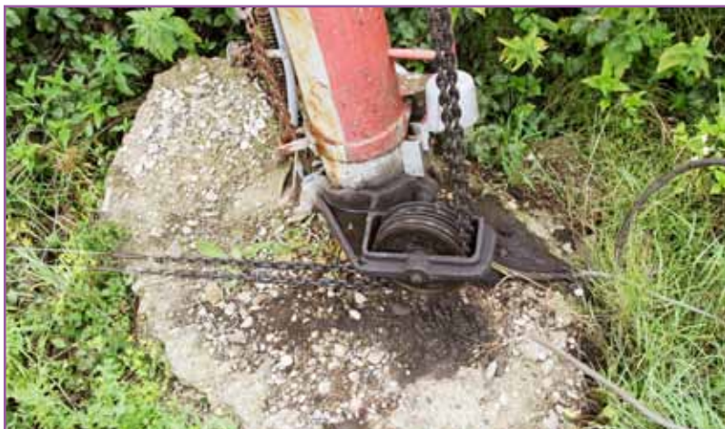
Koróziou oslabená pätka stožiaru a rozrušený betónový základ sú pádne dôvody na komplexnú rekonštrukciu mechanických návestidiel.
