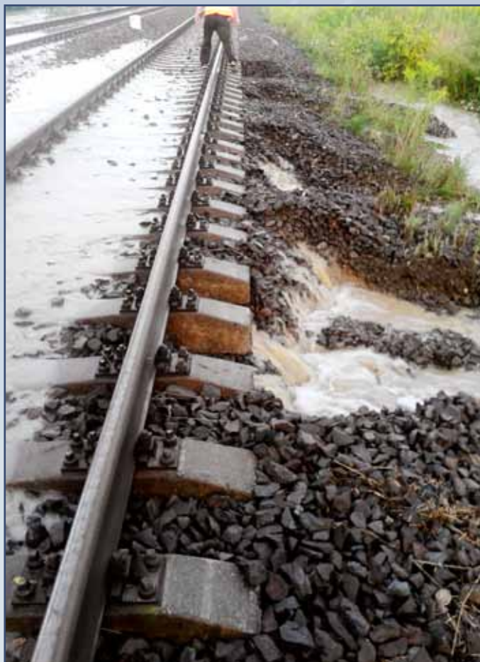
Podmytá trať v úseku Zvolen, nákladná stanica – Výhybňa Slatinka.
