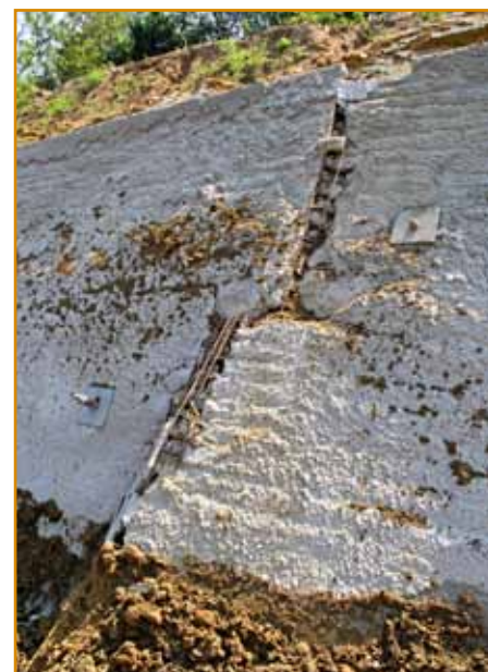
Sila prírody. Tlak nestabilného svahu zanechal takúto stopu v konštrukcii zo striekaného betónu.
