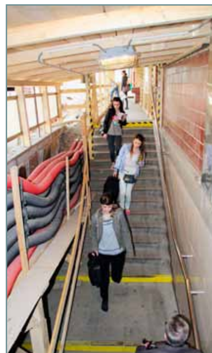
„Bojové“ podmienky staveniska pociťujú aj cestujúci pri vchádzaní zo staničnej haly do pôvodného podchodu.
