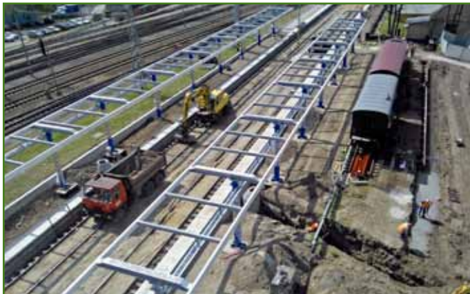
Oceľovú jednotlípovú nosnú konštrukciu zastrešenia tvoria duté oceľové stĺpy, na ktoré sú pripevnené pozdĺžne nosníky. Foto: Tibor KUČERA
