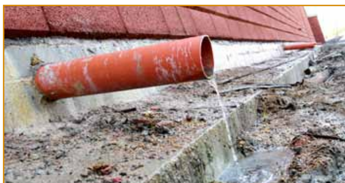
O vysokej hladine podzemnej vody v kopci napovedá aj výtok z drenážneho vývodu.
