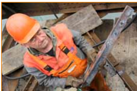
Attila Nagy ukazuje skorodovaný uholník brzdového stuženia.
