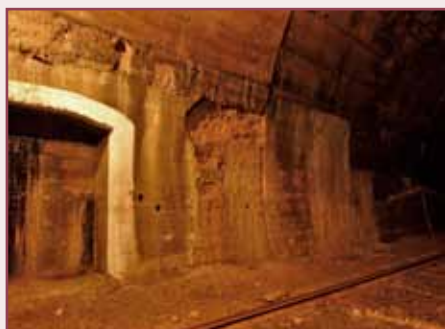
Typický pohľad. Presakujúca voda znehodnocujúca ostenie.
