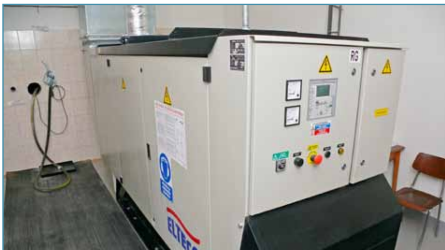
Náhradný zdroj elektriny už diaľkovo sleduje elektrodispečer z riadiaceho strediska.
