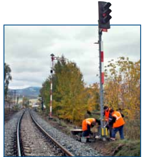
Zamestnanci SMSÚ OZT SO Nové Zámky vykonávajú záverečné úpravy na novom svetelnom návěstidle.
