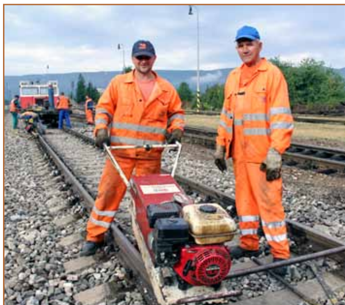
Po geometrickej úprave 1. staničnej koľaje pripravovali Miroslav Hrachiar a Ondrej Chochoľ, zámočníci koľajových konštrukcií z SMSÚ ŽTS TO Košice koľajové styky na termitové zvráanie.
