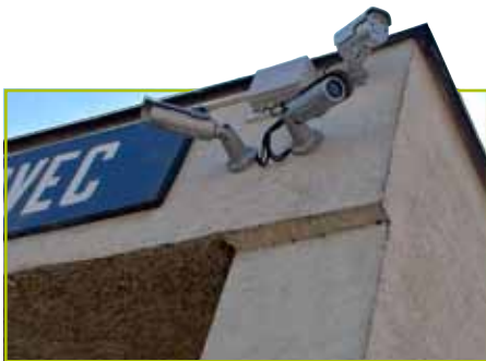
Priestor priecestia v Svrčinovci sledujú 2 kamery, umiestnené na budove zastávky.
