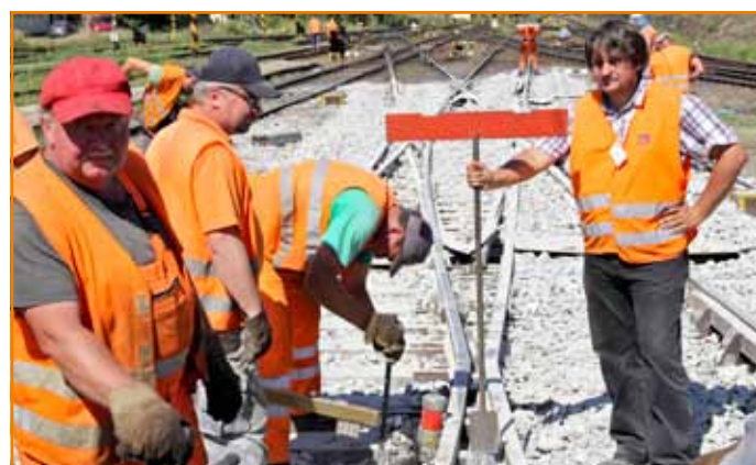
Mgr. Rastislav Šotkovský (vpravo) manuálne pomocou zámerných križov vytýčuje výškovú polohu výhybky, aby chlapi vedeli, o kolko ju ešte musia zdvihákmi nadvihnúť a podbiť.
