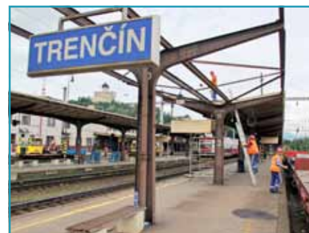
V ŽST Trenčín prebiehajú práce na trakčnom vedení, demontujú sa aj zastrešenia nástupišť.
