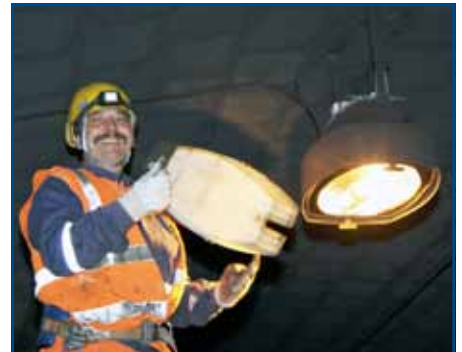
Pavel Gaľa pracoval až pod vrcholom klenby Bujanovského tunela, pretože až tak vysoko sú namontované svetelné zdroje.
