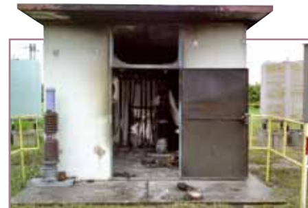
Prírodný atmosférický úkaz poškodil dekompenzačné meniče v domčeku, vedľa stojaci transformátor a prístrojový transformátor napätia v rozvodni 25 kV.
