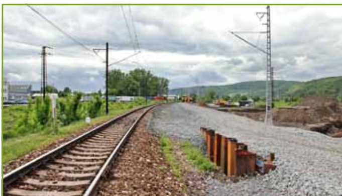
Preloženie trate vykonávali Železničné stavby Košice, a.s. z dôvodu výstavby nadjazdu, ktorý je súčasťou stavby obchvatu Prešova.
