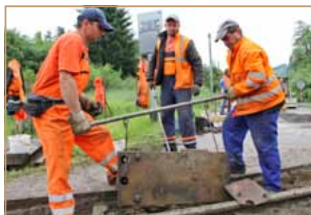
Skorodované diely gumokovu šli z priecestia preč, nahradila ich celopryžová konštrukcia.
