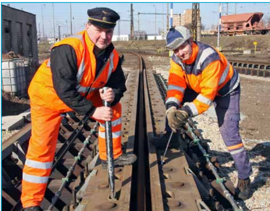
Návěstní majstri, zľava Daniel Rabatin a Róbert Bálint z SMSÚ OZT ZT Košice doťahujú brzdové lišty na ťažovej hydraulickú brzdú - jedinej v Košiciach, ktorej brzdný účinok je závislý iba od rýchlosti a hmotnosti prechádzajúceho odvesu. Podobný typ brzd, ale s pneumatickým pohonom, je ešte vo Zvolene.
