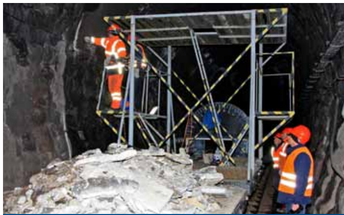
Partia piatich chlapov tunelovej čaty SMSÚ ŽTS TO Topoľčany celý týždeň odstraňovala uvoľnený torkrét z klenby tunela.
