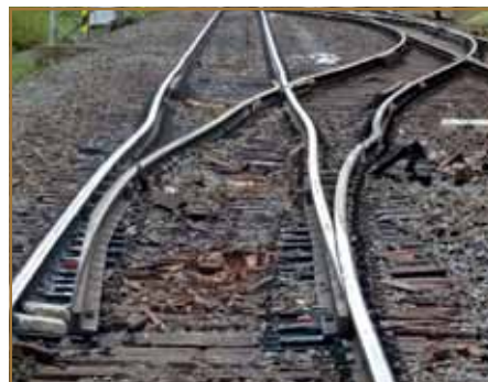
Rozbité podvaly, popraskané koľajnice, poškodené zabezpečovacie zariadenie a zdeformované výhybky. Takáto spúšť zostávala za vykoľajeným vozňom so železnou rudou.
