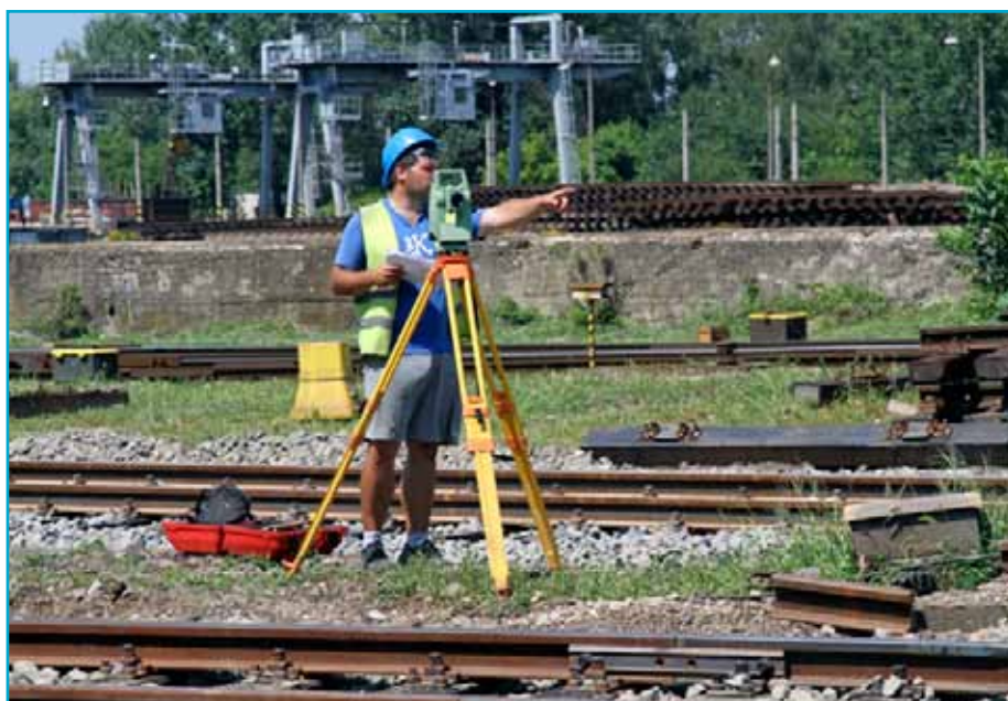
Geodet zhotoviteľa Ing. Jozef Vilčko po zameraní koľaje dáva pokyny obsluhu podbijačky.
