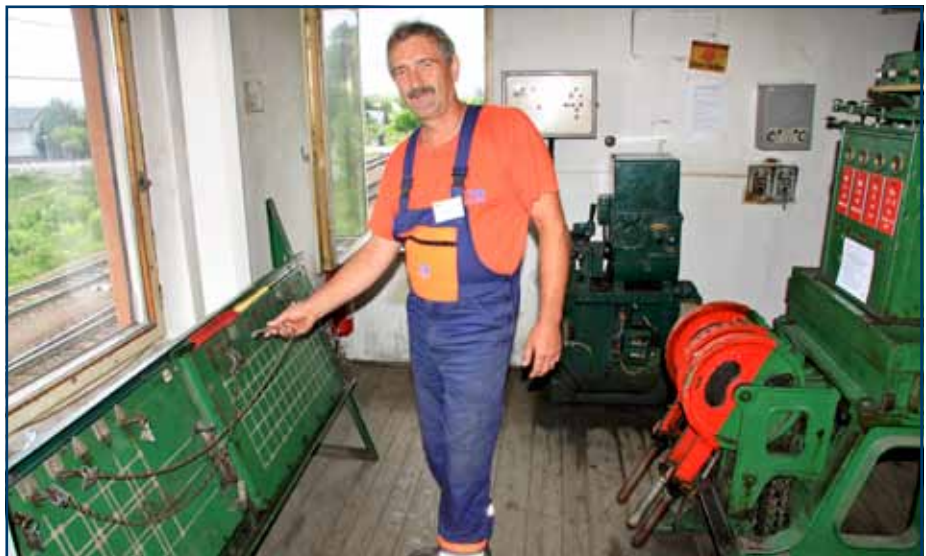
Signalista Jozef Bodnár obsluhuje na stavadle ešte zariadenie z povojnových čias. Okrem stavadlového prístroja zaujme aj ústredná zámka, kde prenos závislostí zabezpečujú obyčajné reťaze.
