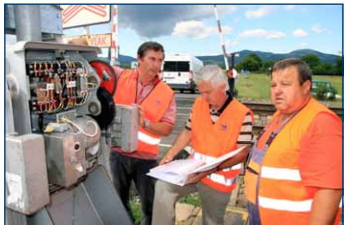
Správne zapojenie elektrických obvodov kontrolujú zľava Ing. Ján Král a Ing. Ján Vojs zo sekcie OZT a František Fekete, návestný majster SMSÚ OZT ZT Slanec.
