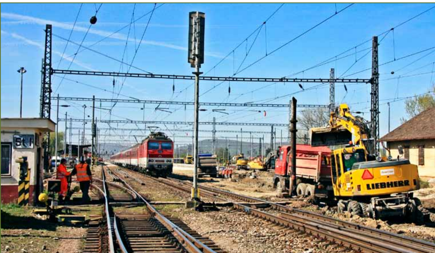
Stavebné úpravy sa vykonávajú aj na oboch výhybkových zhlaviach stanice. Pre vlaky osobnej dopravy je k dispozícii len prvá a čiastočne aj tretia koľaj.
